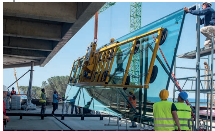
Vakuumsugesystemet VSG 6000 KMH med 15 m lang rute
